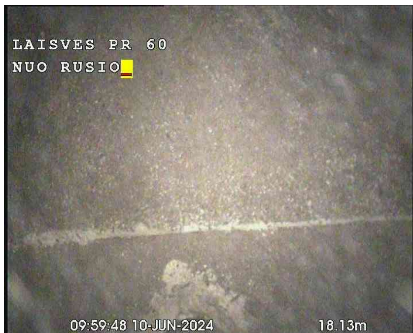
RusysŠulinys_9.jpg, , 18.13m Kanalo galas, šulinys
