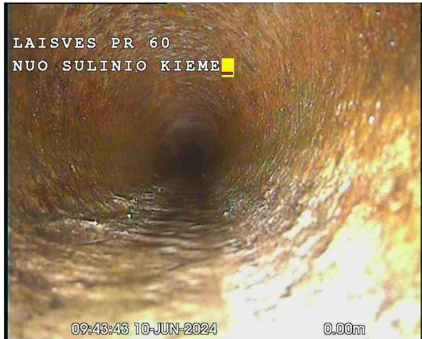
PastatasŠulinys kieme_6.jpg, 00:00:00, 0.00m Kanalo pradžia, šulinys
